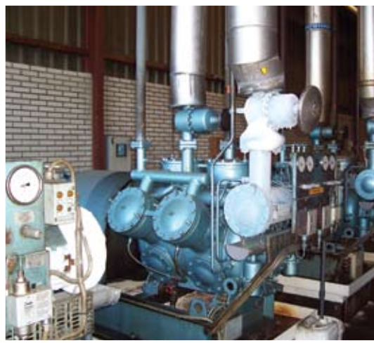
Na een zeer succesvolle test heeft de vestiging van Kloosterboer in Vlissingen besloten alle Grasso-koelcompressoren om te zetten op REFLO 68A. Op de foto hierboven ziet u een van de Grasso-koelcompressoren bij de vestiging in Vlissingen.
